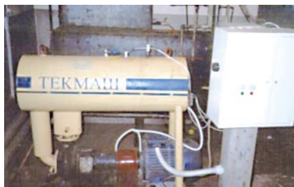
Фото. Тепловыпуск на базе ГТО-3 с аккумулирующей емкостью, двумя контурами отопления, независимым контуром ГВС через теплообменник
